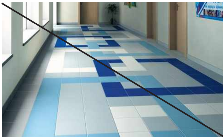
Плохо Цветные вставки из плитки
